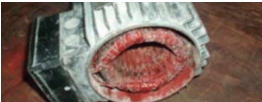
Figura 4. Exceso de contaminantes o múltiples capas de pintura
