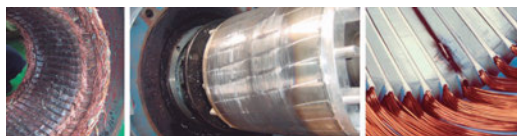
Figura 5. Daños típicos en núcleos laminados.
